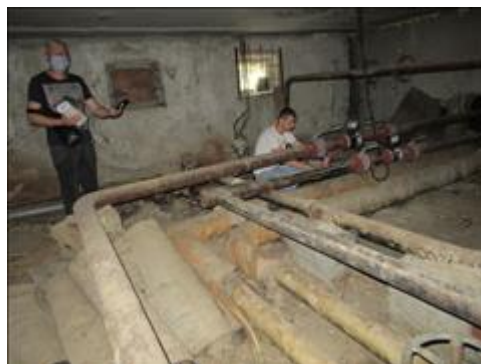
Прикладной общественный жилищный контроль МКД. 02.07.2021 г. Волгоград, ул. Репина,15
