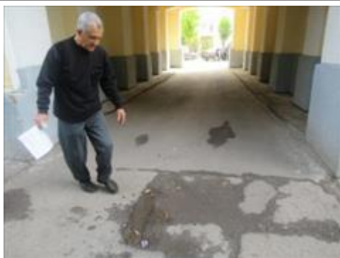
Общественный жилконтроль в г.Волжском, МКД № 6 по ул. Фонтанной
